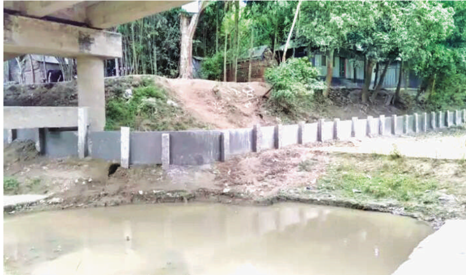
বন্যাগ্রবণ এলাকায় গ্রামীণ রাস্তা ভাঙন প্রতিরোধে সুরক্ষা দেওয়াল Retaining wall to protect village roads in flood prone areas
